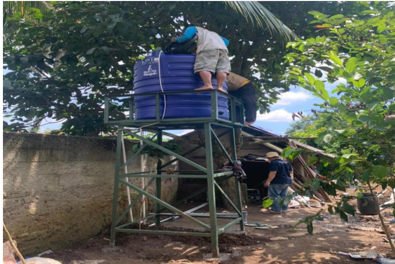
Tangki sumur bor
