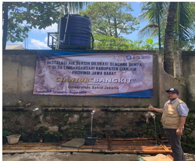
Keran air dari Instalasi Air Bersih
